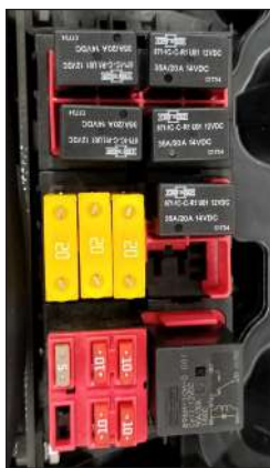
LT4 Fuse Box
